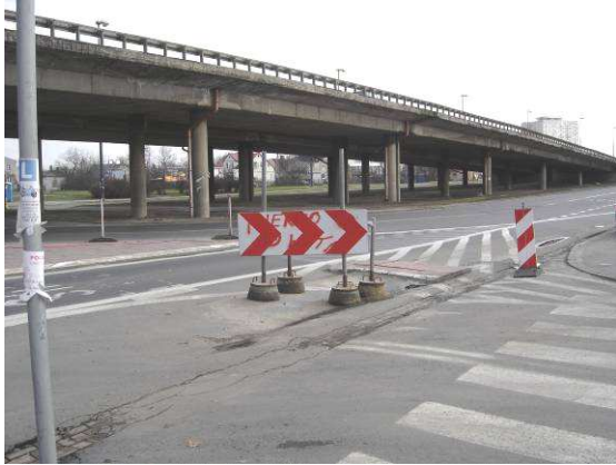
Fot. 16. Skrzyżowanie ul. Modlińskiej z Familijną. Widoczne wymagające poprawy prowizoryczne oznakowanie pionowe i poziome.
