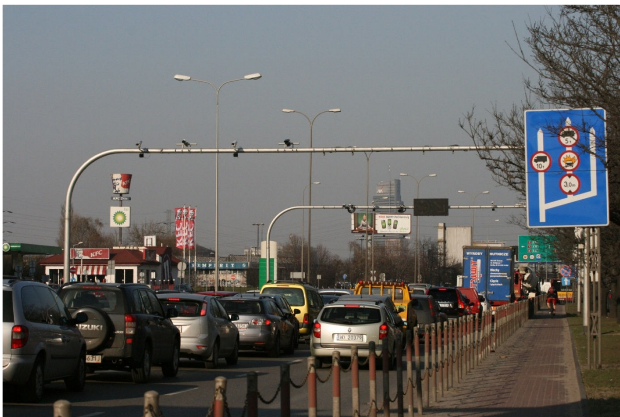
Rys. 9. Bramownice wykorzystane w testach i oznakowanie pionowe przed bramownicami
