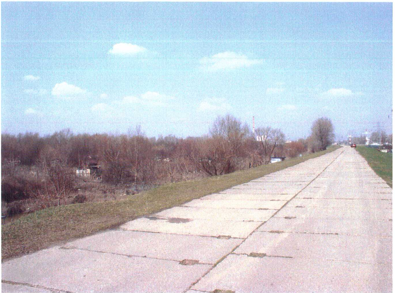
Wiz. 2. A. Widok w kierunku północnym wzdłuż wału przeciwpowodziowego na wysokości FSO. Stan istniejący.
